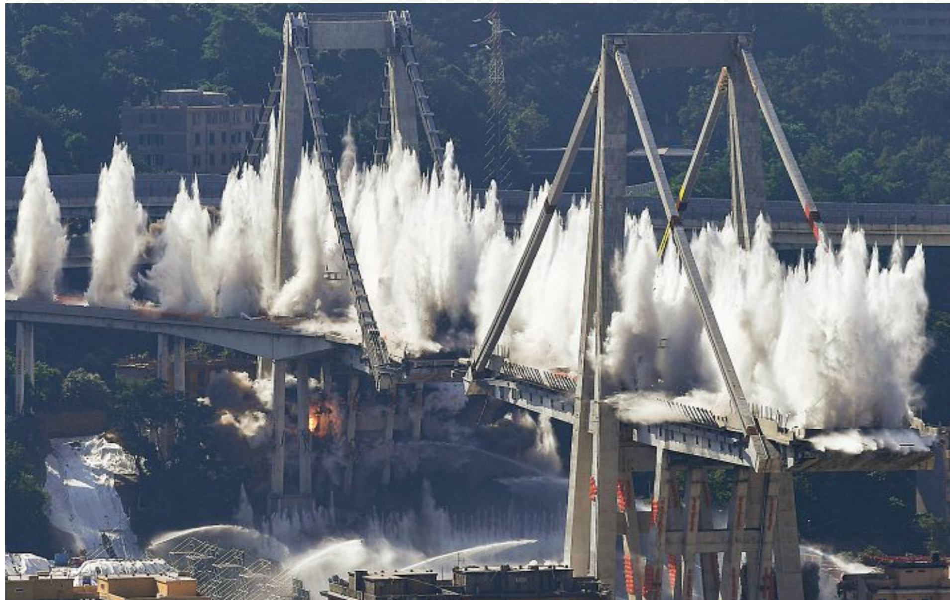
Zu Staub geworden: Elf Monate nach dem Einsturz der Morandi-Brücke in Genua, bei dem 43 Menschen umkamen, werden die Überreste der Autobahnbrücke gesprengt.
