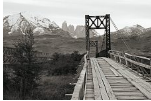
Der Puente Negro („Schwarze Brücke“) des Ingenieurs David Rowell geht über den Rio Paine.
