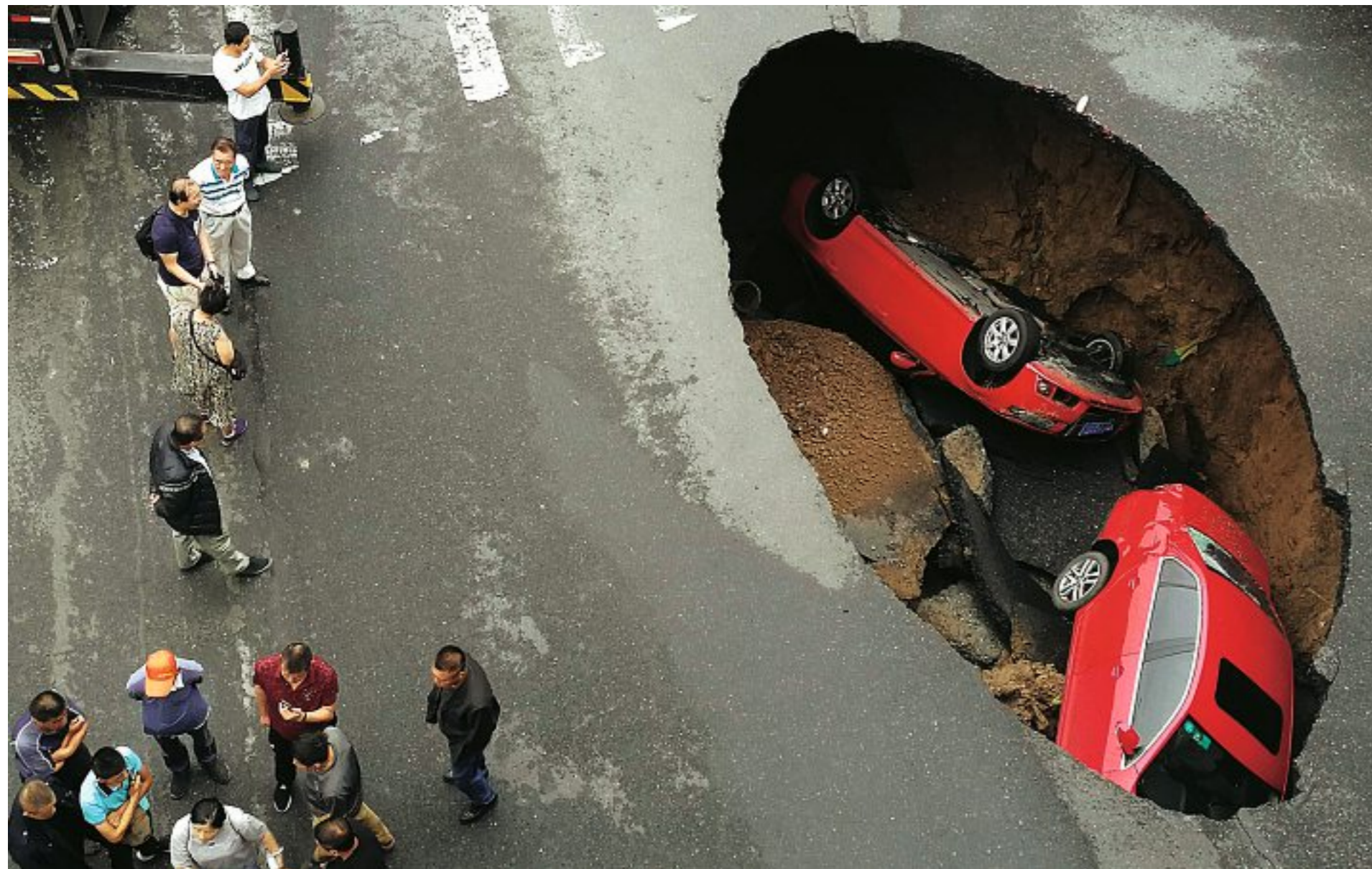
Fast zehn Meter lang und mehr als vier Meter tief: Zwei Autos sind in der Zehn-Millionen-Stadt Harbin in ein Loch gestürzt, das nach heftigen Regenfällen in Chinas nördlichster Provinz entstanden war.
